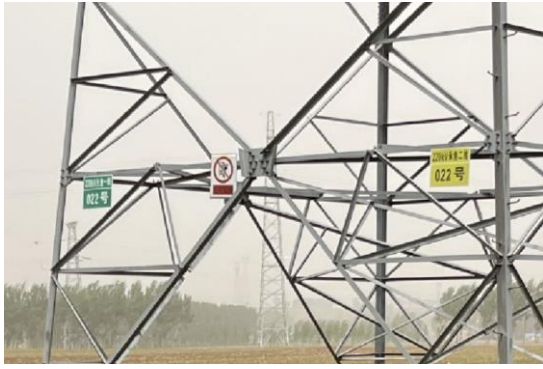
220kV 永鱼一线塔身警示标识
