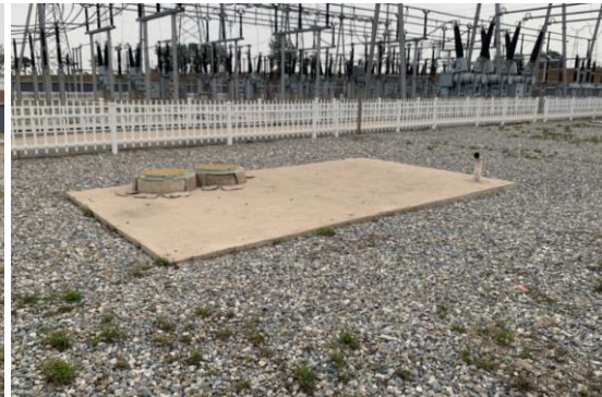
220kV 昌北（郭家）开关站事故油池
