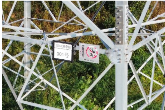
220kV 洛牵线塔身警示标识
