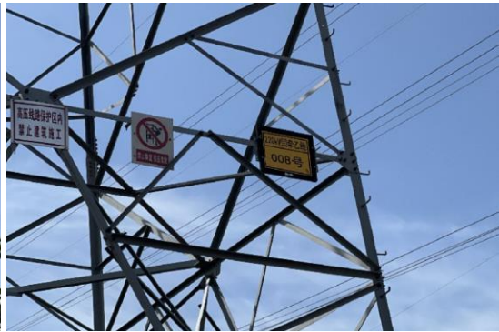
220kV 阎瓦乙线塔身警示标识
