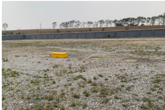
220kV 昌北（郭家）开关站污水处理装置
