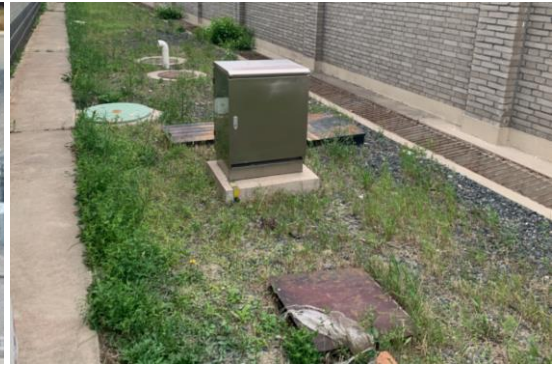
220kV 新城子开关站埋地式污水处理装置
