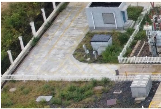
220kV 陆港开关站地埋式污水处理装置
