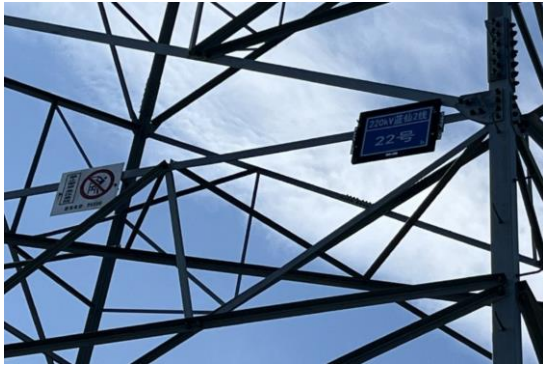
220kV 蓝仙 2 线塔身警示标识
