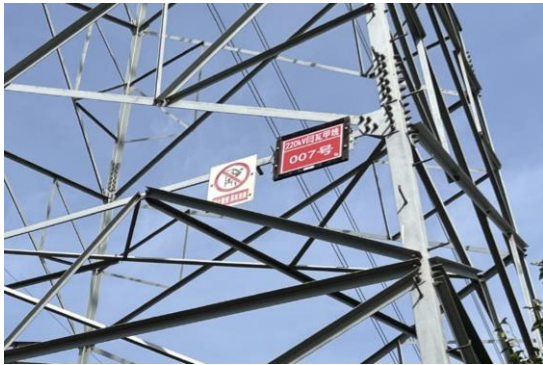
220kV 阎瓦甲线塔身警示标识
