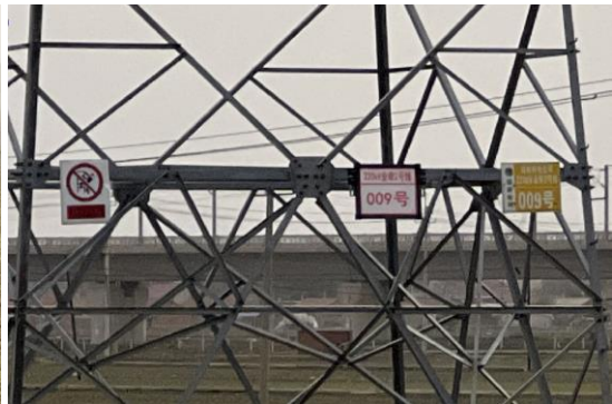
220kV 业牵 2 线塔身警示标识
