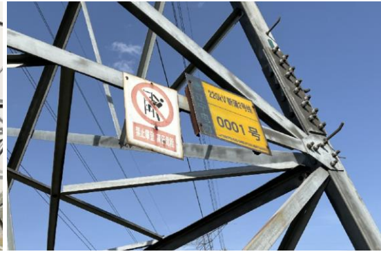
220kV 新蒲二线塔身警示标识
