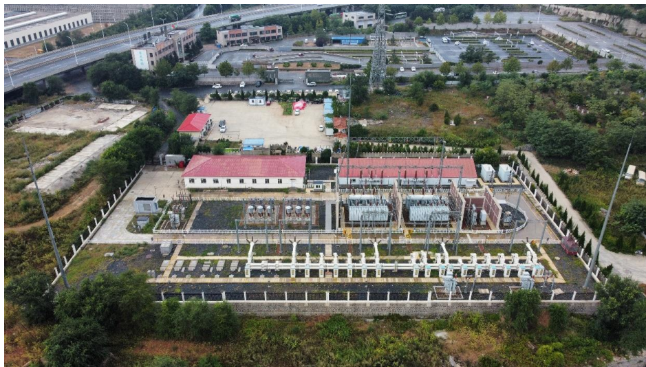
1-1) 新建 220kV 陆港开关站工程
