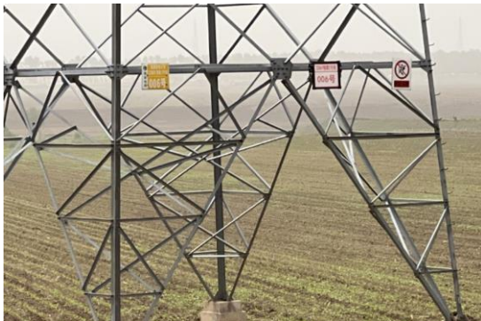
220kV 郭牵 2 线塔身警示标识
