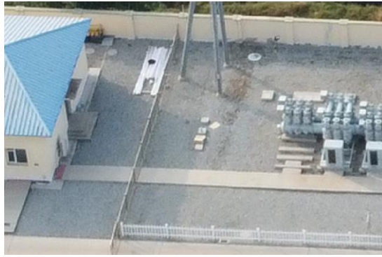
220kV 博洛铺开关站埋地式污水处理装置
