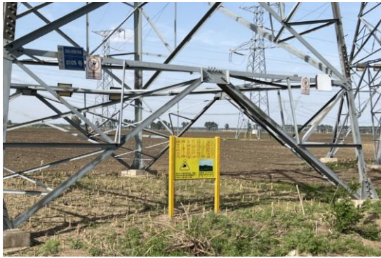
220kV 铁新一线警示标识
