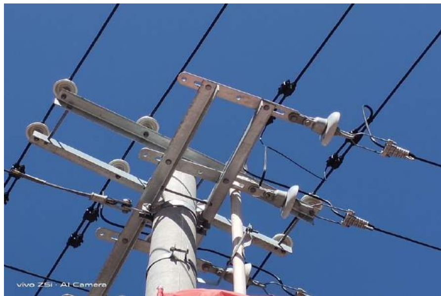
低压线路T接
